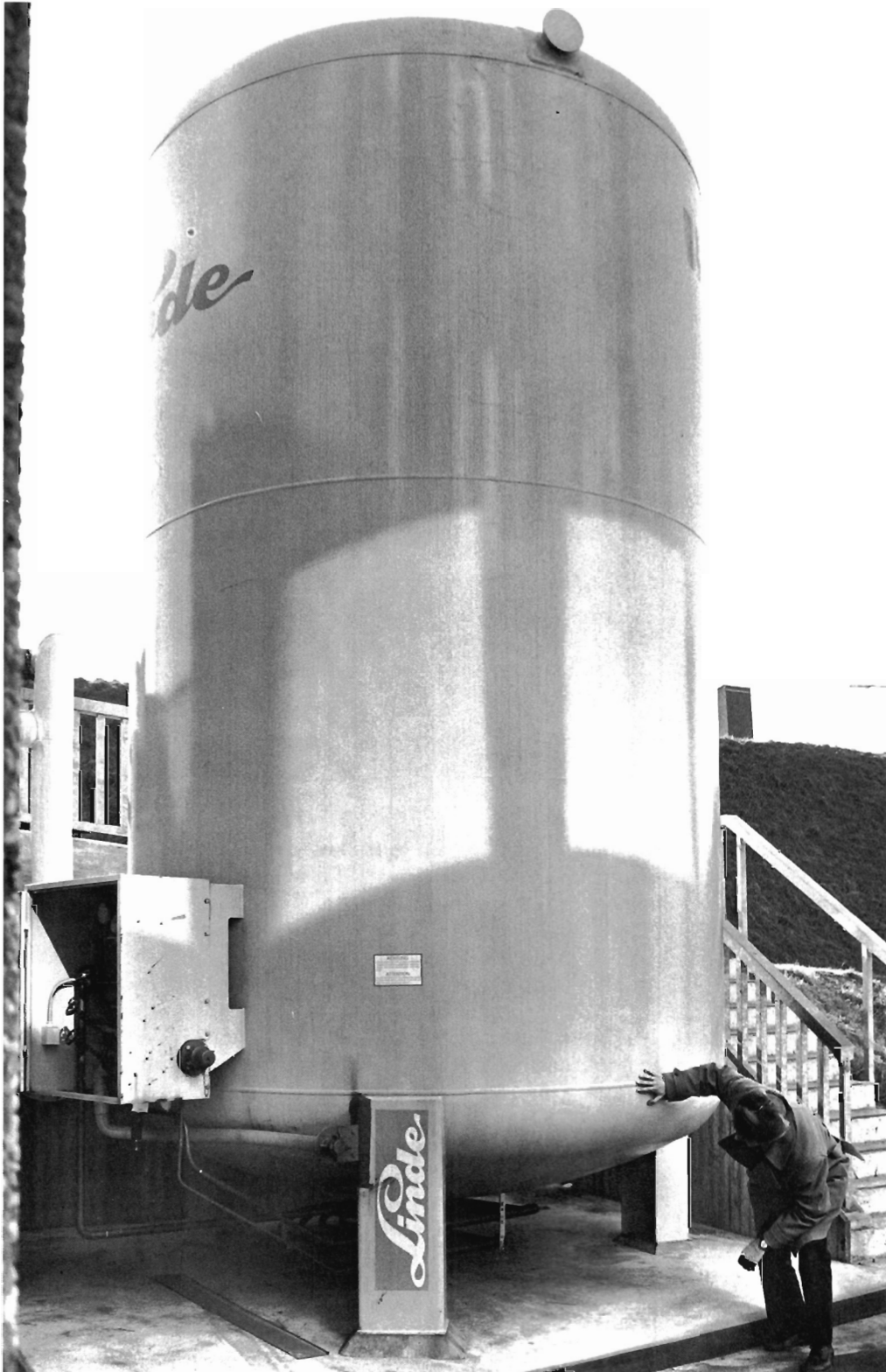
Abb. 109 FI. Stickstoff-Versorgungstank – Pluto und Speicherring
