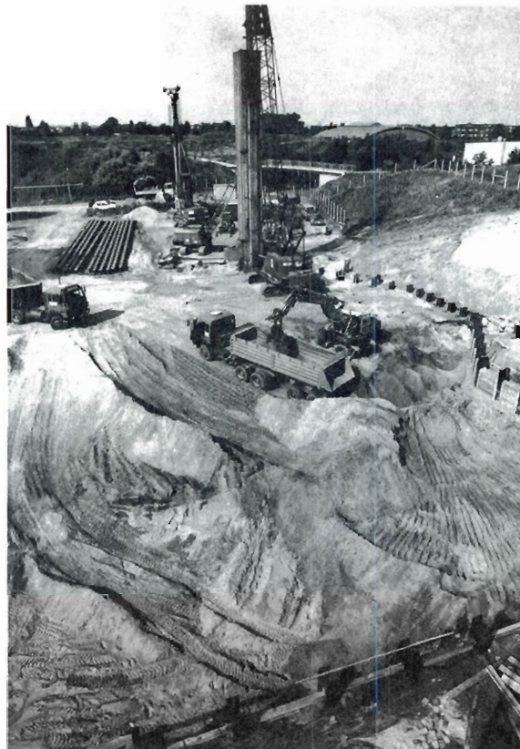
Abb. 20.10: Die HERA-Baustelle West auf dem DESY-Gelände im Anfangsstadium. Es werden die Träger zur Abstützung der Seitenwände in den Boden gerammt.
