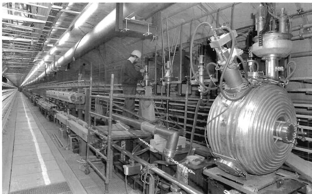
Abbildung 63: Aufbau eines kompletten 208-MHz-Hochfrequenzsystems für die Beschleunigung von Protonen im HERA-Tunnel.
