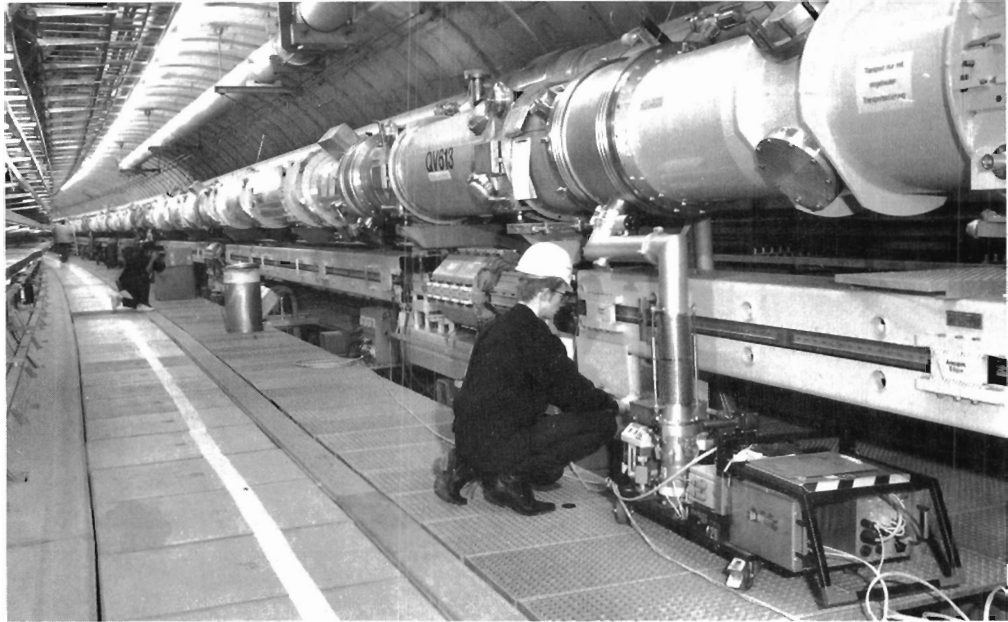
Abbildung 70: Fertig installierte Magnetstrecke im Oktanten West-Links mit supraleitenden Dipolen und Quadrupolen oberhalb des Elektronenringes. (42001/3)
