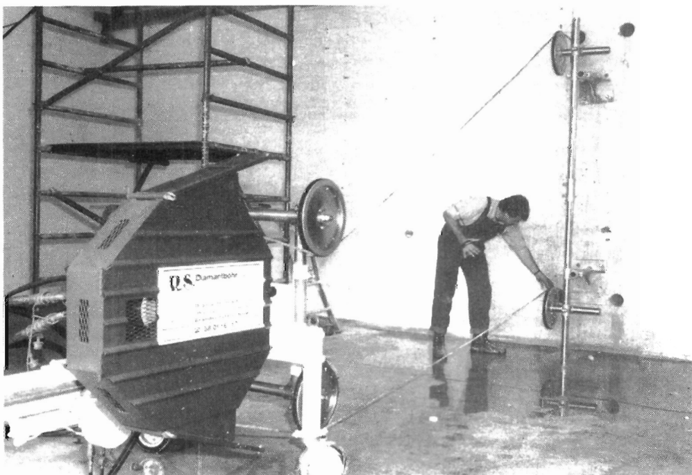
Abbildung 56: Säge, mit der Teile der zwei Meter starken Betonabschirmwände von DORIS II herausgelöst wurden. Die Säge benutzt ein diamantbeschichtetes Seil zum Heraustrennen der Betonquader. (42084/1)
