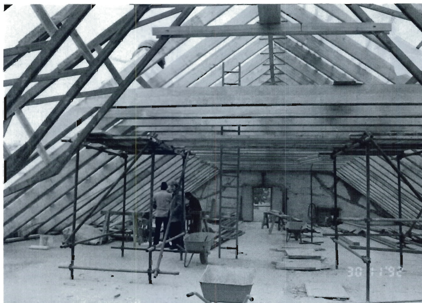
Abbildung 76: Erneuerung des Dachstuhl des Laborgebäudes. Im Vordergrund sind noch Teile des alten Dachstuhl zu sehen.
