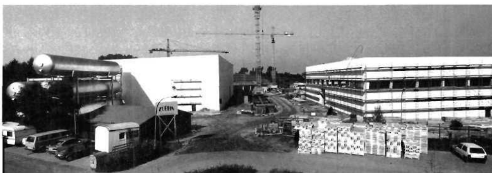
Abbildung 84: Blick auf die neue Magnettest-Halle (rechts) und auf die neue Kältetechnik-Halle (links) mit den ersten fünf Helium-Tanks. (39166/1)
