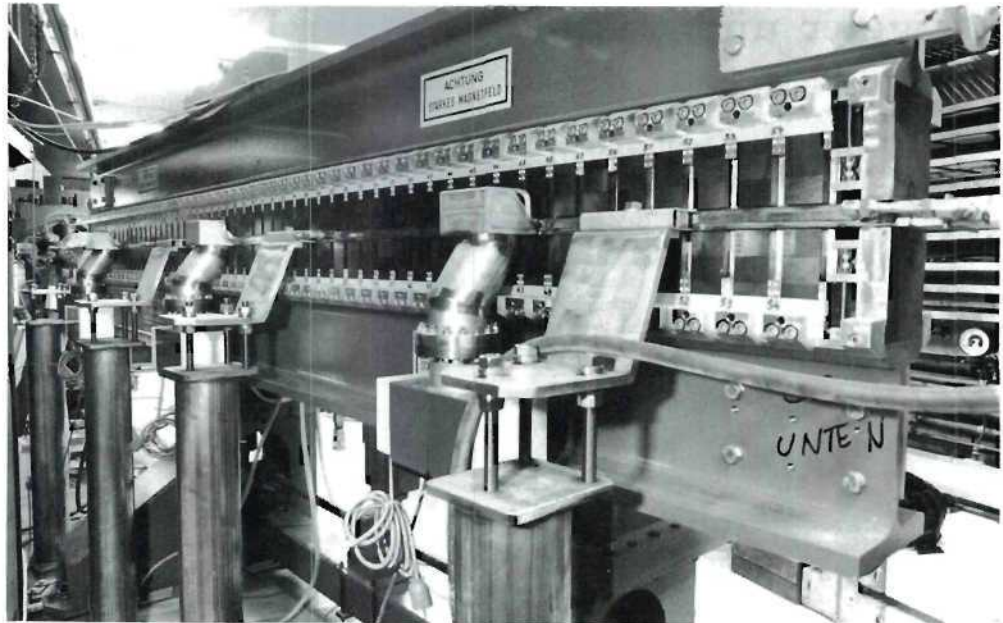
Abbildung 44: Ein Blick von der Außenseite des Speicherrings entlang eines auf Position BW1 eingebauten Wigglers. Der Elektronenstrahl bewegt sich von rechts vorn nach links hinten. Es ist eine Vakuumkammer mit einer äußeren Höhe von 30 mm eingebaut, die von vier Trägern außerhalb des Rings gestützt wird. Vakuumkammer und Wiggler sind mechanisch vollständig getrennt. Das Gap ist bis auf sein Minimum von 30 mm geschlossen. (42299/21)
